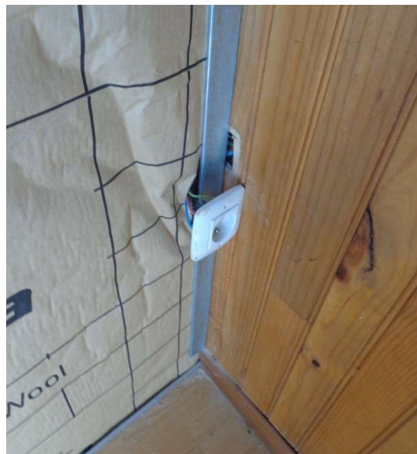
Risque électrique constaté chez un particulier dans la Marne, après une intervention isolation à 1 €
